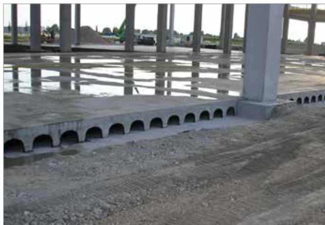
Vide sanitaire ventilée pour chambre froides
