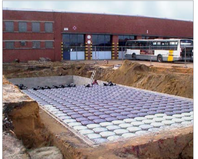
Park alanının altındaki biriktirme deposu
