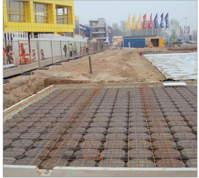
Ticari park alanının altındaki biriktirme deposu
