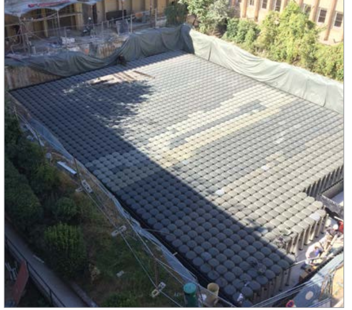
Mesken bölgenin altındaki su toplama tankı
