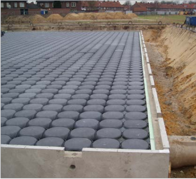
Seranın altındaki toplama deposu
