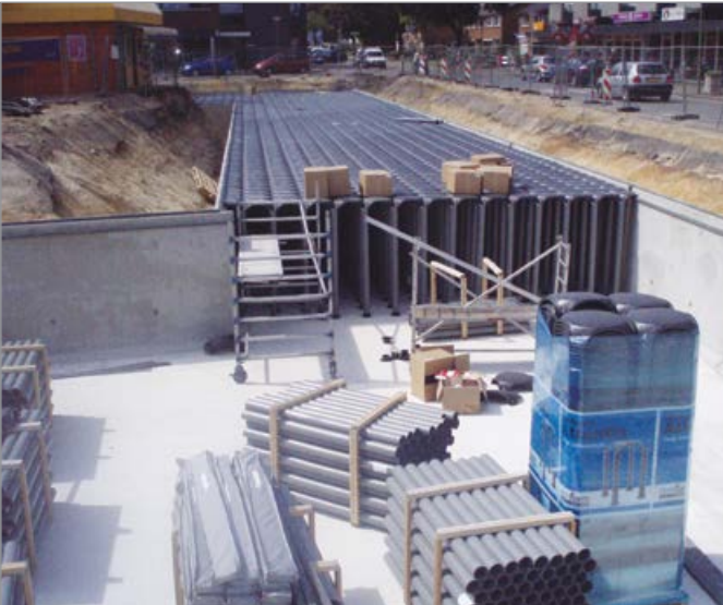
Ticari park alanının altındaki biriktirme deposu
