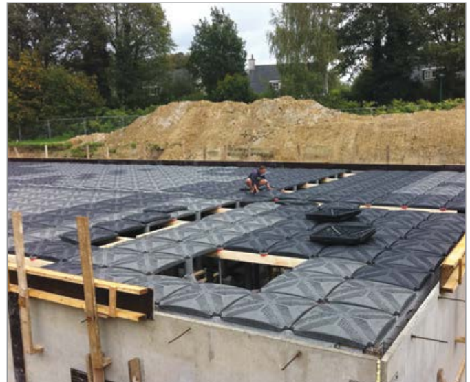
Yağmur suyu toplama tankı
