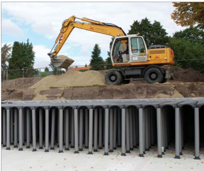
Wasserverteilbecken unter einem Wohnbereich
