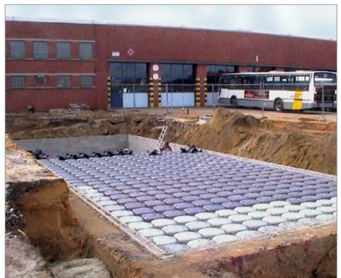
Sammelbecken unter einem Parkplatz
