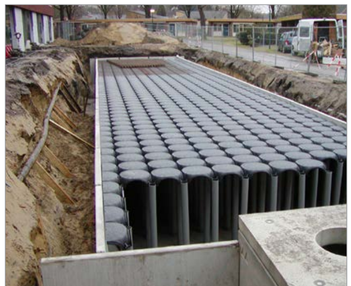
Verteilbecken unter einem Wohnbereich
