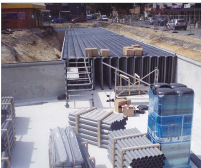
Sammelbecken unter einem Geschäftsparkplatz
