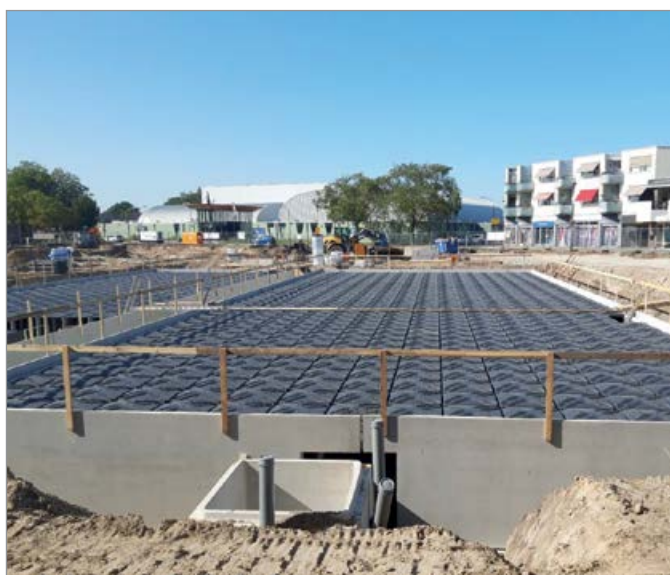
Spridnings tank under en parkeringsplats
