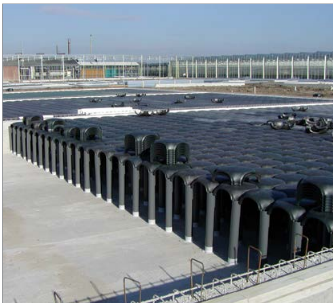
Vattensamlings tank i växthus
