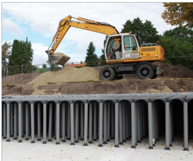
Vattenuppspridningstank under bostadsområde
