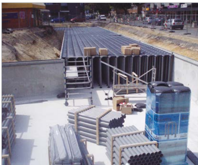
Spridnings tank under en kommersiell parkeringsplats
