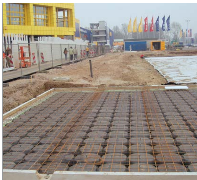
Spridnings tank under en kommersiell parkeringsplats
