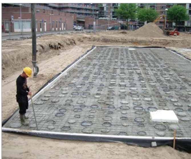
Spridnings tank under en parkeringsplats
