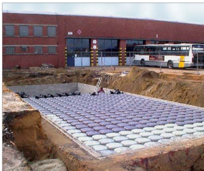
Spridnings tank under parkeringsplats
