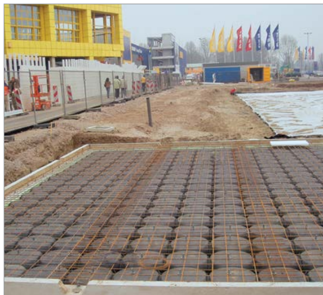
Zbiornik gromadzący znajdujący się pod parkingiem komercyjnym
