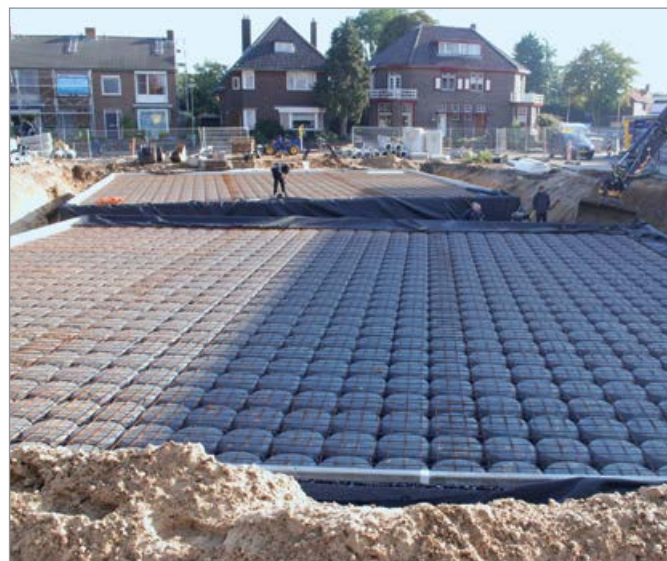
Zbiornik dyspersyjny pod placem
