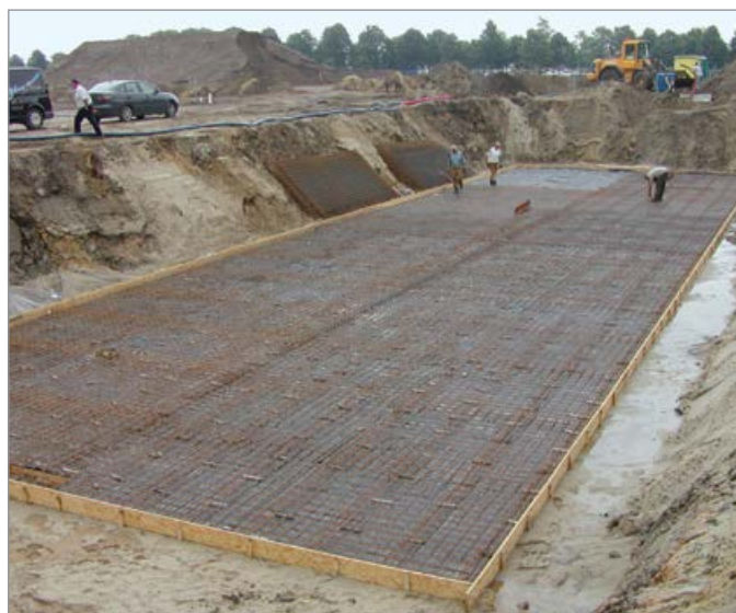
Tanque de recolha de água
