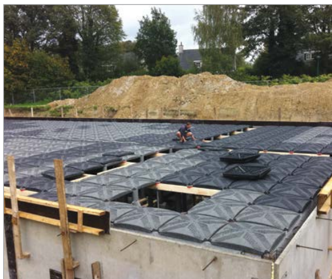
Tanque de acumulação de águas pluviais
