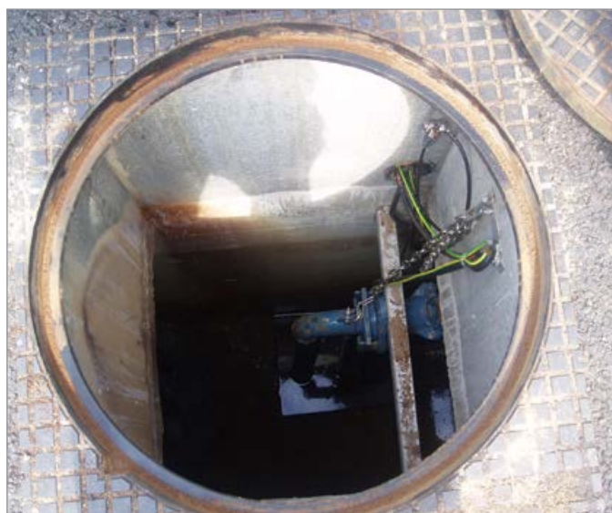
Caixa de inspecção
