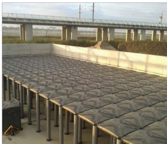
Сборочный бассейн воды
