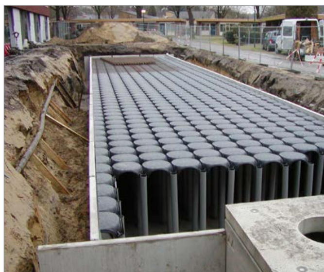
Резервуар для распределения воды под жилой зоной
