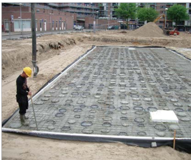
Резервуар для распределения воды под стоянкой
