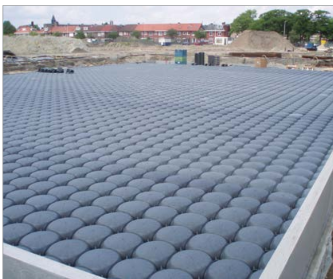
Резервуар для распределения воды под промышленной зоной
