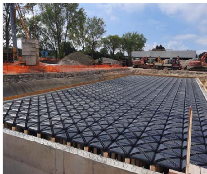
Резервуар для распределения воды под промышленной зоной
