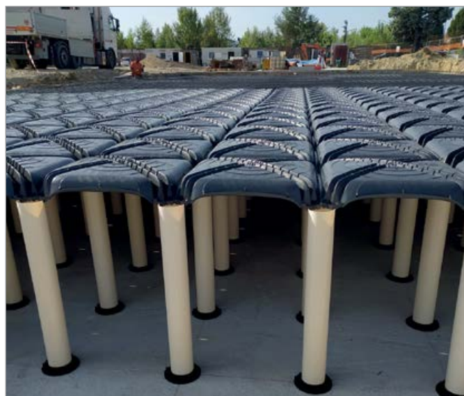
Резервуар для распределения воды под промышленной зоной
