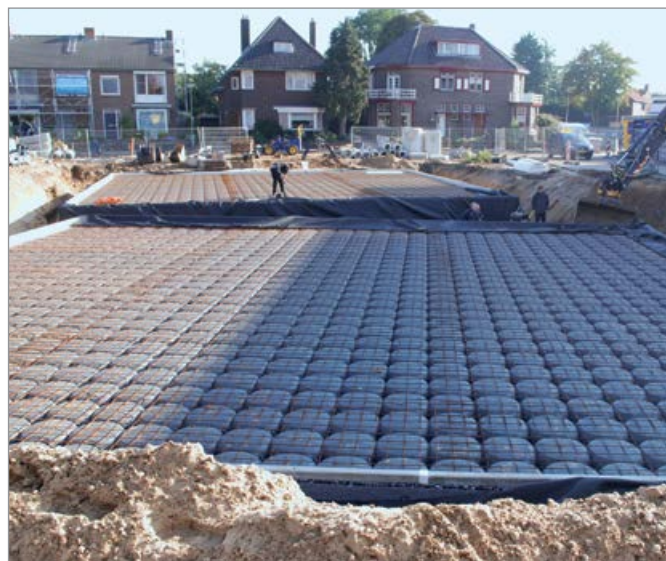
Резервуар для распределения воды под стоянкой
