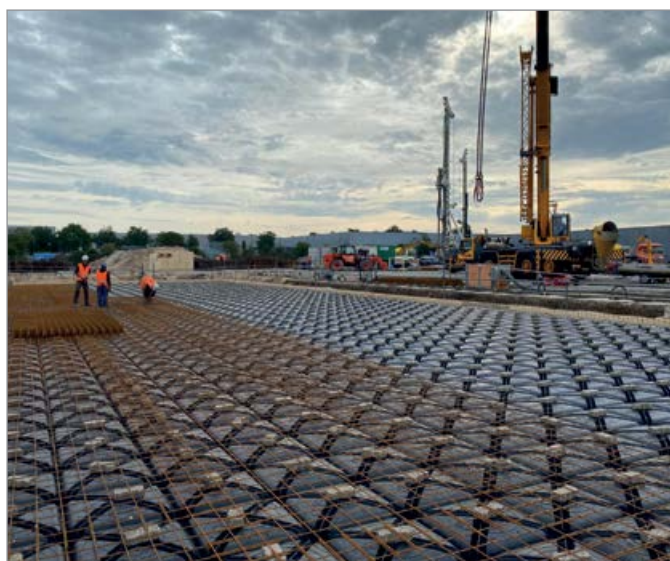
Резервуар для распределения воды под промышленной зоной
