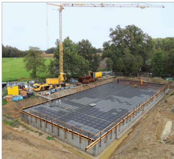
Сборочный бассейн воды
