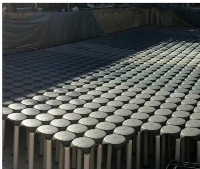
Uppsamlings tank för regnvatten
