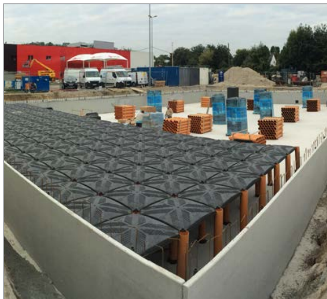
Uppsamlingskärn för regnvatten i en shoppinggalleria
