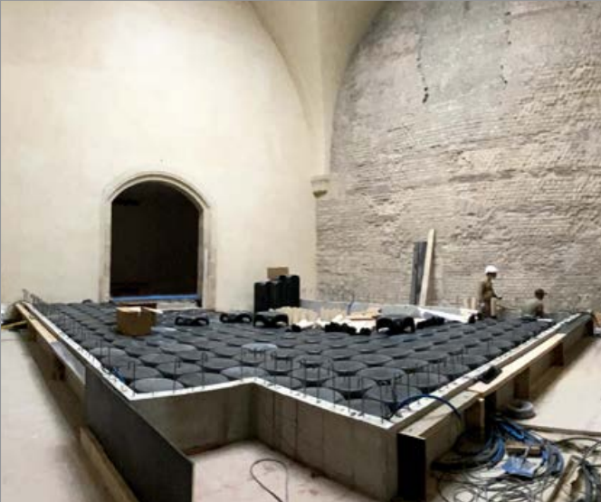
Sistemlerin geçişi için yükseltilmiş döşeme
