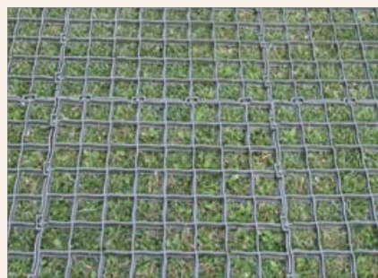
Easy Park tuż po instalacji
