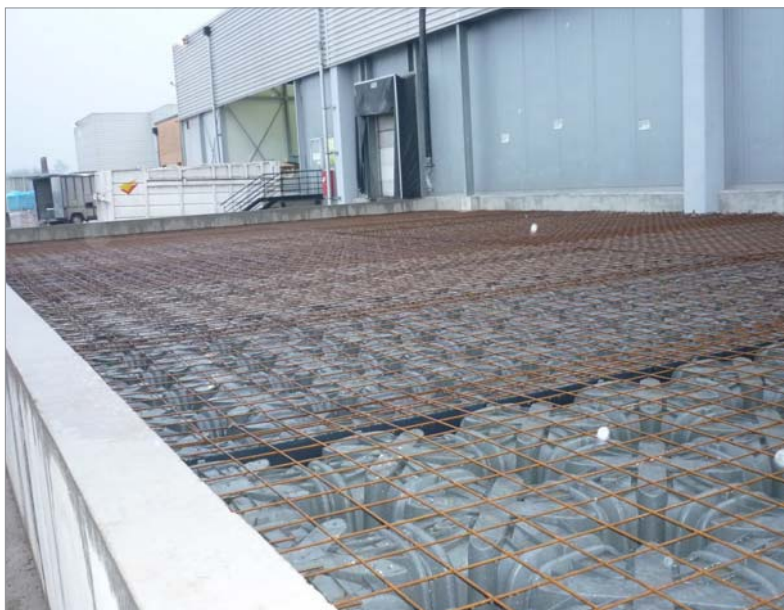
Chambre froide négative - France
