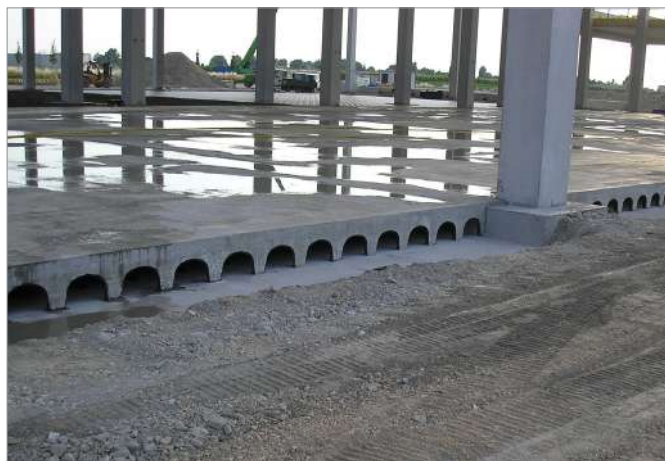
Belüftungshohlraum für Kühlzellen
